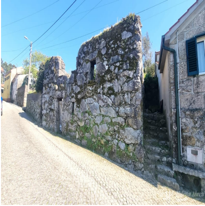
Habitação em ruína para restauro Figueiró
